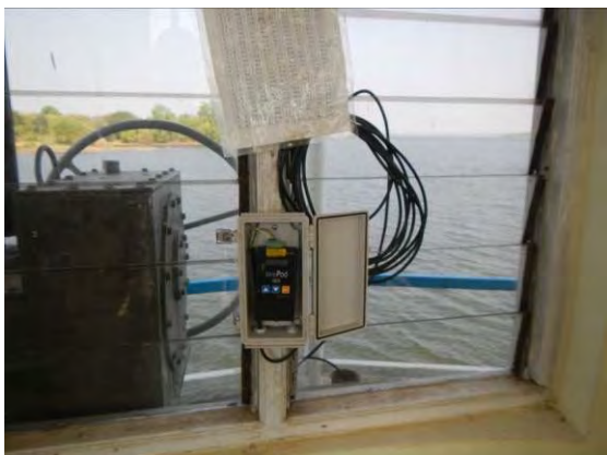
図 6-3-9 取水塔内の水位記録計
