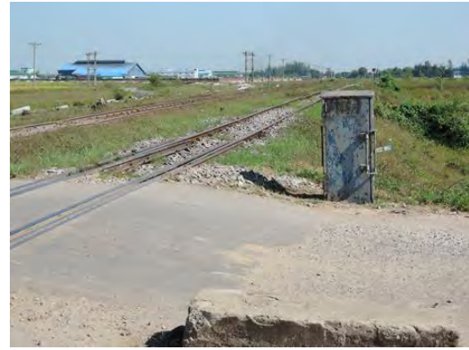
写真-38： チャンシッター踏切には 600V の地中電線が通過しており、受電接続箱に端子がある。
