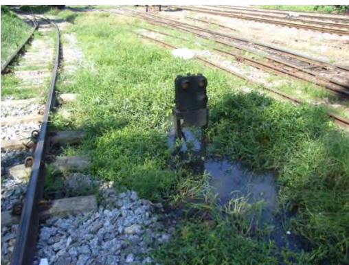
写真-11 : 駅構内東南部は近隣のアパートなどからの生活排水が流れ込んでおり、写真のように入換信号機が水に浸かってしまっている箇所がある。
