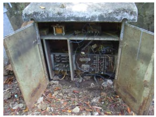
写真-10 : 構内の信号器具箱内部の様子。列車検出のための軌道リレーが収まる。線路冠水の影響を受け、状態は良くない。
