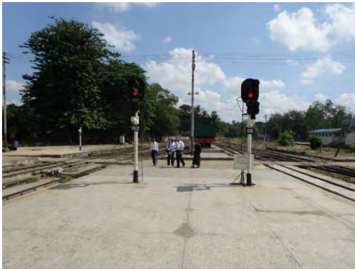
写真-9 : ヤンゴン中央駅付近の幹線とヤンゴン環状線は色灯信号式である。信号機構の現示はLED化されている。
