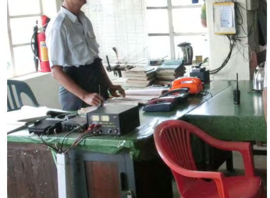
写真-28： ヤンゴン中央駅信号扱所の駅長机にある通話設備。複数の電話装置、無線設備が備えられている。全て新扱所に移設する為のケーブル布設が必要
