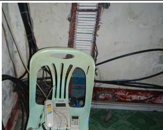
写真-29： ヤンゴン中央駅通信機器室の通信接続架。ここから新扱所まで、電話装置等のケーブルを敷設する。
