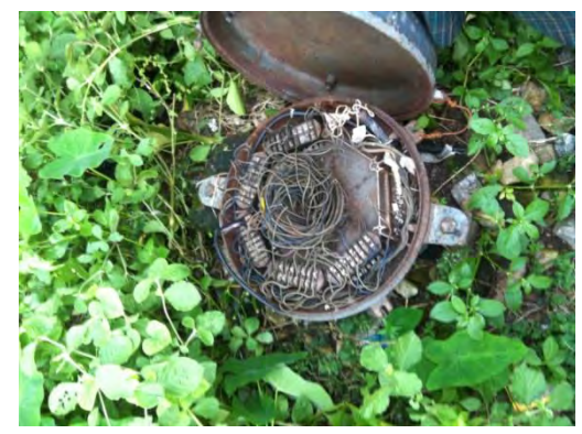
写真-22： ヤンゴン中央駅とは違い、線路付近の道沿いの接続箱のみが設置されている。これは水平形の接続箱
