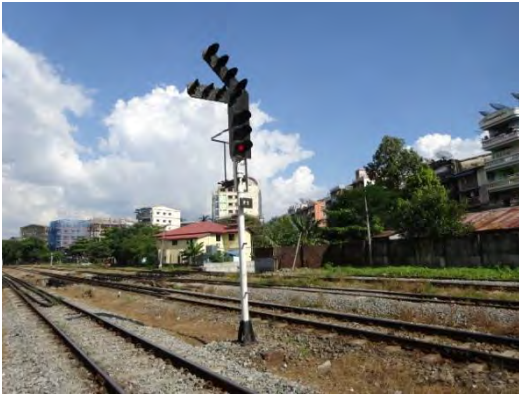
写真-21： 独式の信号機構で、進路表示器と一体となっている。信号現示はLED化されている。
