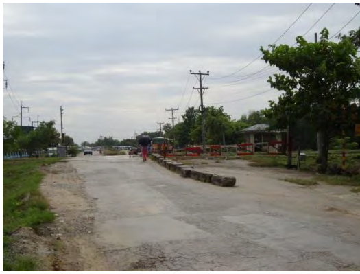
写真-31： チャンシッター踏切は2車線路であるが踏切道床が崩れており、現在片側を封鎖している。
