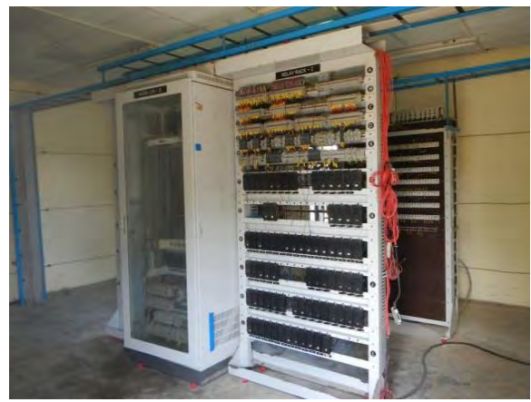
写真-40： TMS 駅装置を設置する駅で行われている電子連動装置 (SSI) 設置工事。この機器室のスペースにTMS 駅装置を設置する。(リーダウカン駅)
