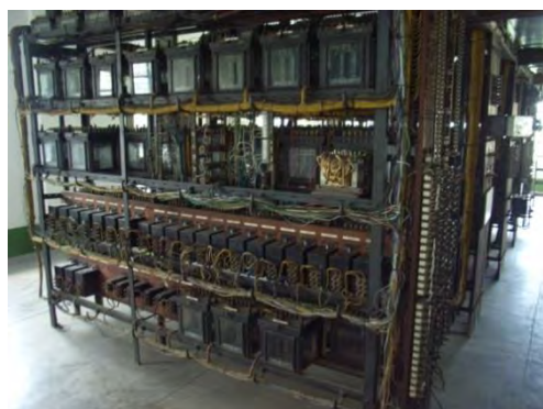
写真－５： 信号扱所下の信号機器室。リレー及びその配線を含め、1950年の使用開始当時の設備が中心に構成されている。
