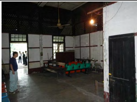
写真-41： ピュンタサ駅では現通計機器室にスペースがない為、駅建物内の空き部屋を信号機器室として整備してTMS 駅装置を設置する。
