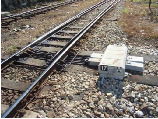
写真-19： 独式の電気転つ機。1970年から使用している。バズンダン駅では線路冠水はないとのことである。
