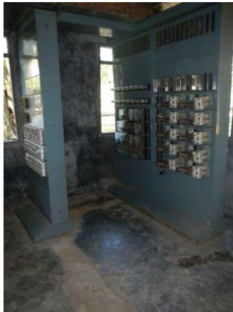
写真-39： 各駅で設けるTMS 駅装置を設置する継電動機器室。現行の機器からも一部静電を取得する。(ファウンドリー駅)
