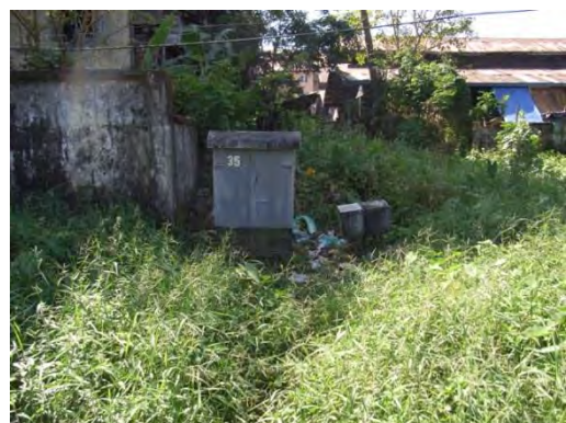
写真-12 : 同じく駅構内東南部の信号器具箱の様子。生活排水の流れ込みやゴミが散乱しており、設置環境が非常に悪い。
