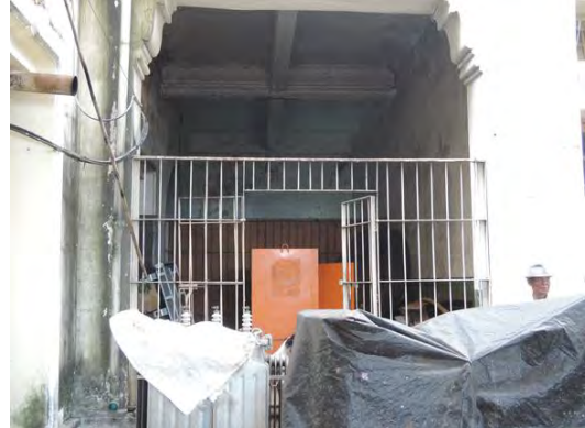
写真-26： ヤンゴン駅本屋の東端 1 階に現行の信号用予備発電機が設置されている。
