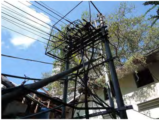
写真-25： ヤンゴン駅の既設の配電線路は奥に見える YESB 配電室から電力が供給されている。
