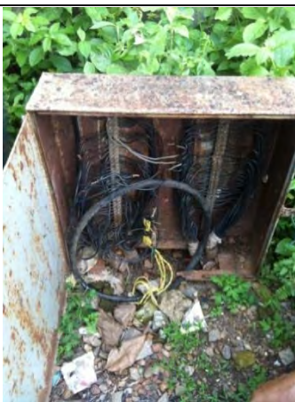
写真-23： 垂直形の接続箱。信号ケーブルは直埋設されているため、端部だけが地面から出ている。
