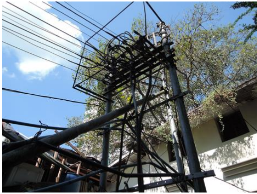
写真-25： ヤンゴン駅の既設の配電線路は奥に見える YESB 配電室から電力が供給されている。
