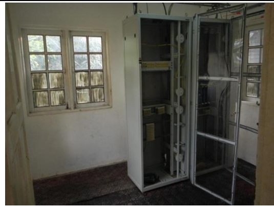
写真-44： TMS 中央装置と各駅装置を接続する既設光ケーブルの接続架。中央装置、各駅装置ともこの架を介してネットワークを構築する必要がある。
