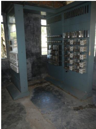
写真-39： 各駅で設けるTMS 駅装置を設置する継電動機器室。現行の機器からも一部静電取得する。(ファウンダーティー駅)
