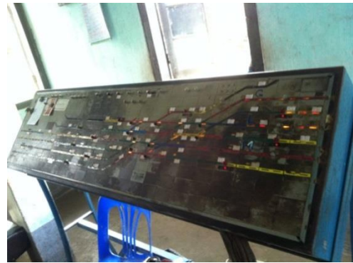
写真-16： パズンダン駅信号扱所の制御盤。独シーメンス製で使用開始は1970年である。進路数は18である。
