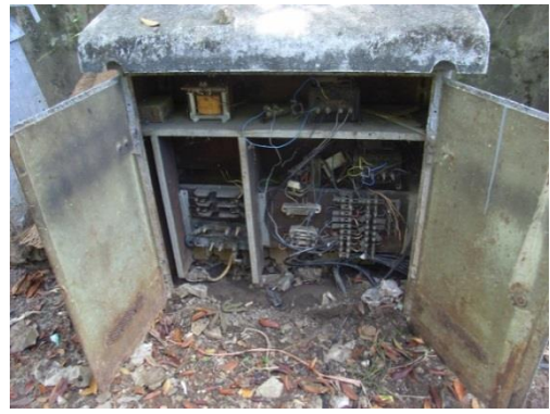
写真-10： 構内の信号器具箱内部の様子。列車検知のための軌道リレーが収まる。線路冠水の影響を受け、状態は良くない。
