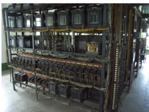
写真－５： 信号扱所下の信号機器室。リレー及びその配線を含め、1950年の使用開始当時の設備が中心に構成されている。
