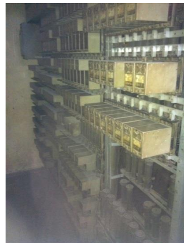
写真-18： 信号機器室内部の様子。ヤンゴン中央駅との違いは駅間軌道リレーの一部が設けられている。
