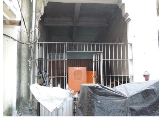
写真-26： ヤンゴン駅本屋の東端 1 階に現行の信号用予備発電機が設置されている。
