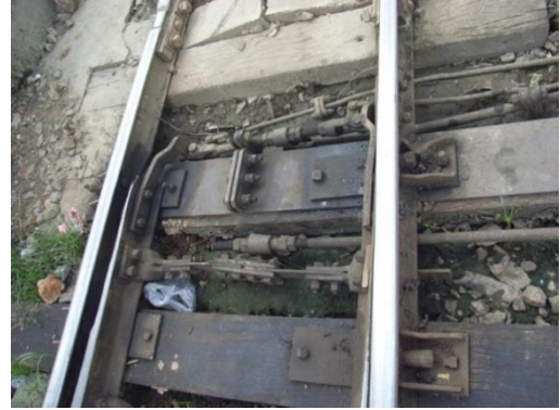
写真-8： 転てつ木属装置。予備品がなく1950年から修理しながら使用されている。状態は良くない。
