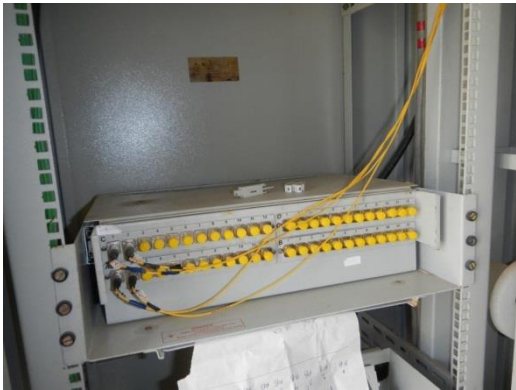
写真-45： 光ケーブル接続架の局内終端架。この終端架に TMS 各装置からの接続ケーブルを布設する必要がある。
