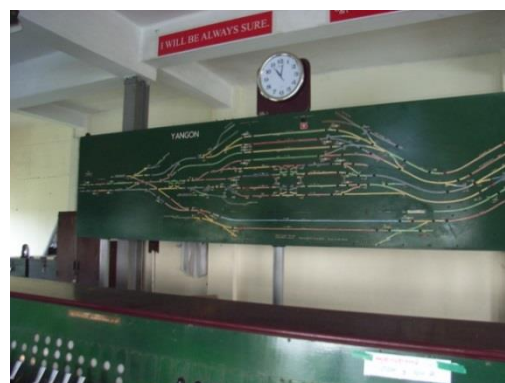
写真－４： 信号扱所内の表示盤。駅構内の連動範囲の列車在線位置を把握できる。パズンダン駅隣駅外。
