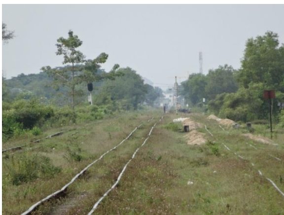
写真-35： 当該区間では、信号機等は使用されておらず、列車の進来は警笛により踏切警手に知らせている。
