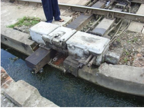
写真-7： 英式の電気転てつ機。これも1950年から使用しており、修理しながら使われ続けている。
