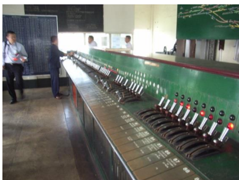
写真－３： ヤンゴン中央駅の信号扱所。写真中のレバーにより進路構成を行う。
