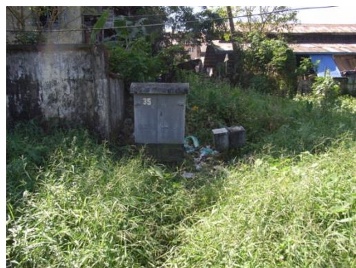
写真-12： 同じく駅構内東南部の信号器具箱の様子。生活排水の流れ込みやゴミが散乱しており、設置環境が非常に悪い。
