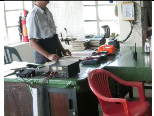
写真-28： ヤンゴン中央駅信号扱所の駅長机にある通話設備。複数の電話装置、無線設備が備えられている。全て新扱所へ移設する為のケーブル布設が必要
