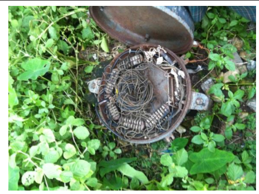
写真-22： ヤンゴン中央駅とは違い、線路付近の道沿いの接続箱のみが設置されている。これは水平形の接続箱
