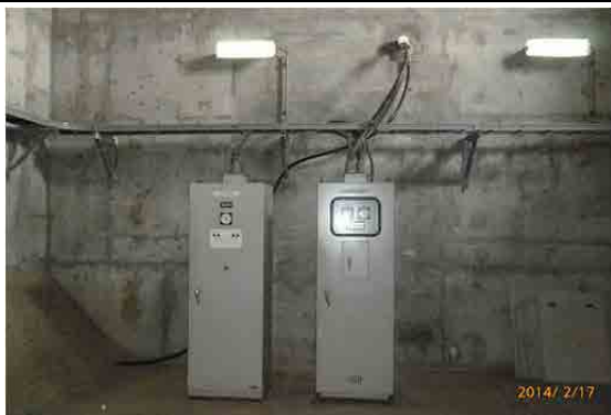
Panneau de réception électrique à l'intérieur des ancrages (1 A) : emplacement prévu pour la mise en place des équipements de déshumidification de l'espace en biseau.
