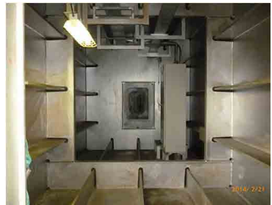
Intérieure de l'entretoise située au milieu du pylône Local prévu pour l'installation des équipements de séchage par injection d'air
