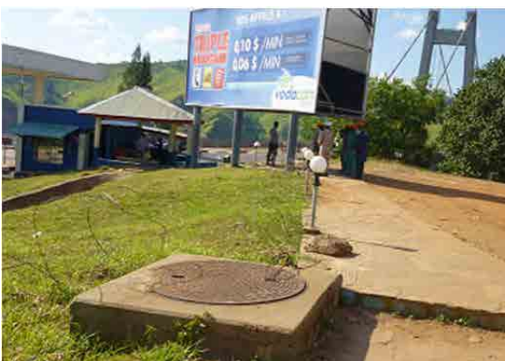
Regard de relais des câbles d'alimentation électrique du pont. Le pont est visible en arrière-plan à droite.
