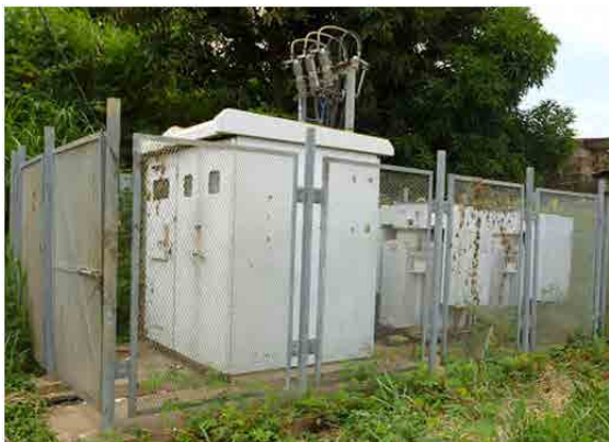
Équipements électriques : à gauche panneau de réception électrique du pont, et à droite transformateurs du courant en entrée n°4 et n°5
