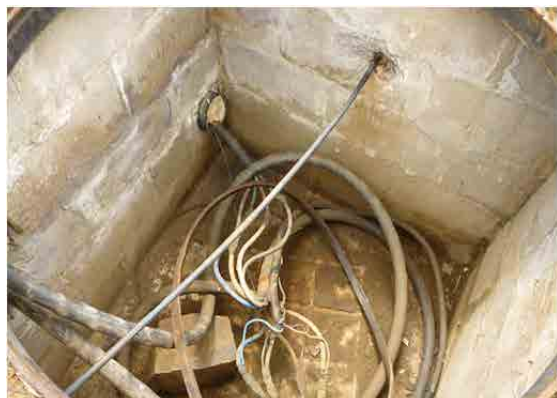
Présence de traces de submersion à l'intérieur d'un regard de relais des câbles d'alimentation électrique
