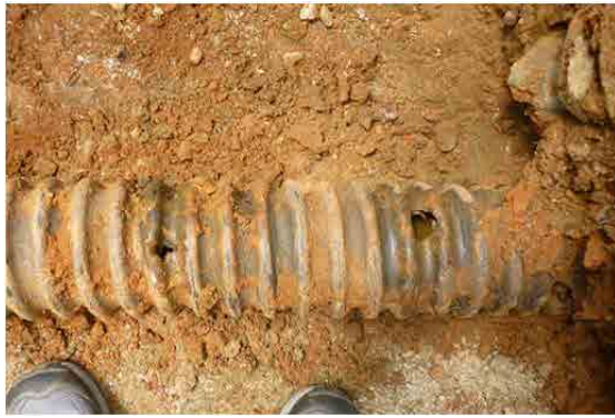
Gaines de protection des câbles (enterrés). Elles sont vétustes et déchirées par endroit.
