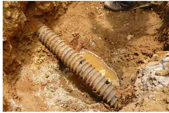
Présence d'eau à l'intérieur des gaines, les câbles électriques sont en état de submersion.
