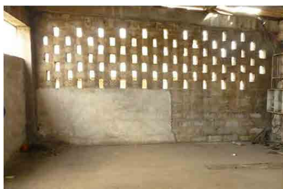
Intérieur du bâtiment. Il y a suffisamment de place pour installer le panneau de réception.
