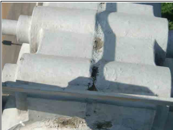
ケーブルバンドの一般状況。上塗りの一部が剥げ、中塗りが見える。
