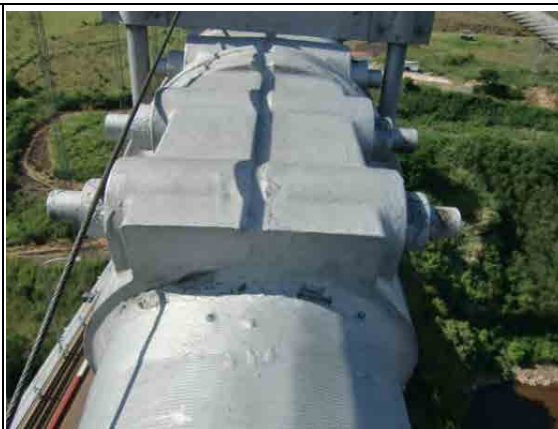
バンドとケーブルの境界部のコーキングと塗装のはがれ。
