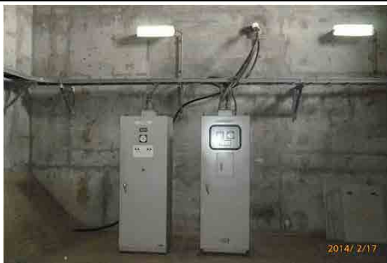
アンカレイジ（1A）内部の受電盤、スプレー室の除湿設備設置予定場所。
