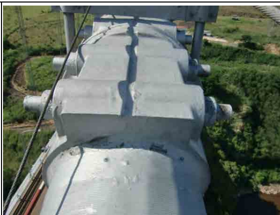
バンドとケーブルの境界部のコーキングと塗装のはがれ。
