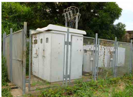
受電設備 左側は橋の配電盤、その右は受電トランス No.4 と No.5。
