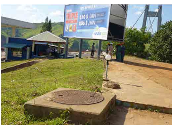
橋の給電ケーブル中継用マンホール右後方に橋が見える。
