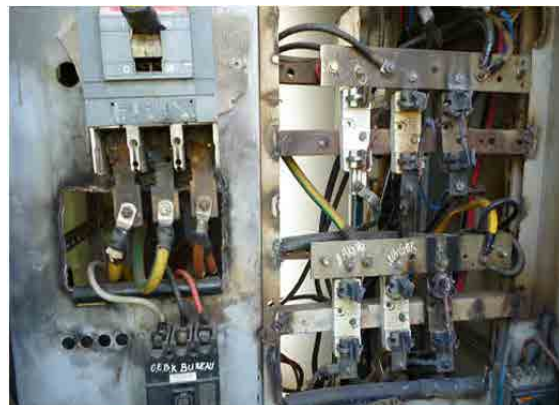
配電盤内部 使用に耐えないほど老朽化 更新が必要。
