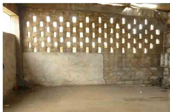
建物内部 受電盤設置スペースは充分有り。
