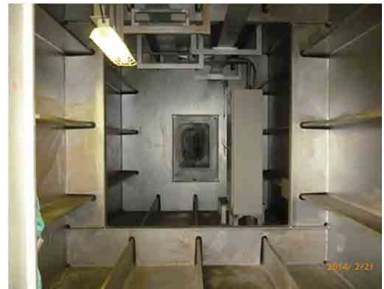
塔中間の水平材内部 送気乾燥設備設置予定場所。
