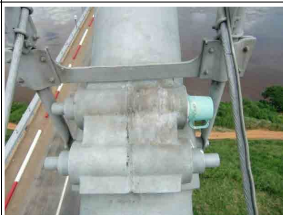
ボルトキャップに応急的にコップが代用されている。
