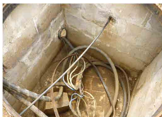
給電ケーブル中継用マンホール内部水没の跡有り。
