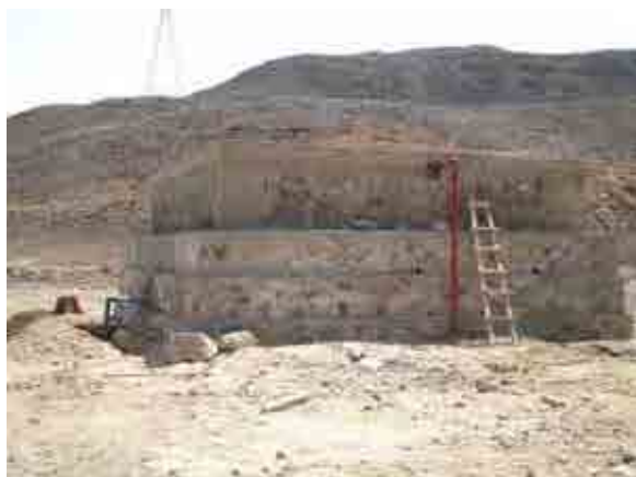
Réservoir (site Hambokto)
