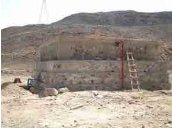
Water Tank (Hambokto)
