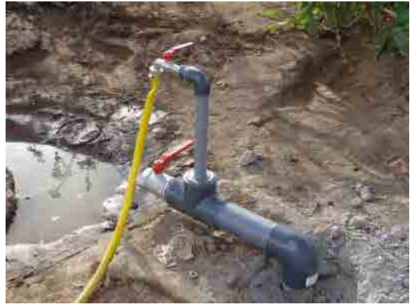
給水栓 (Kourtimalei地区)
