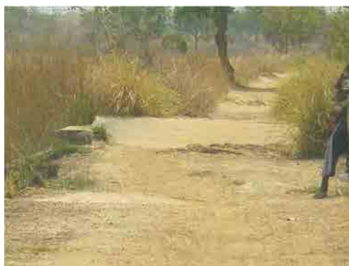
破損したカルバート（通行不可）
