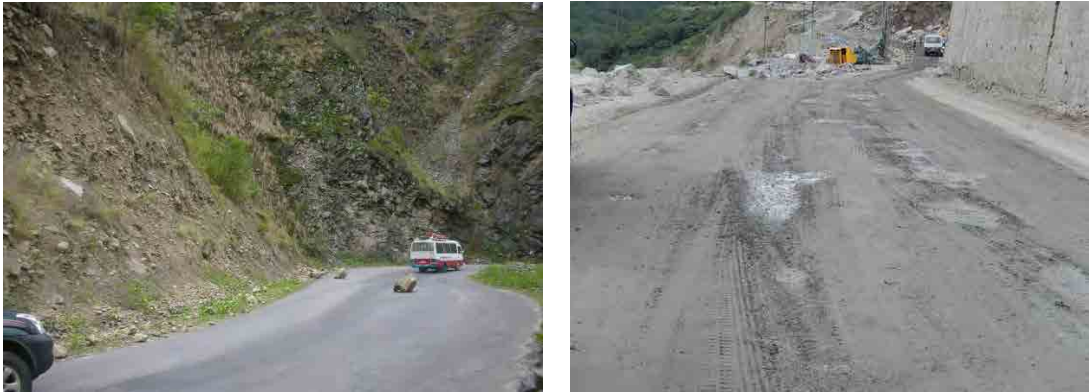
出所：調査団撮影（左）落石の多い個所、（右）プナチャンチュ発電所付近の路面 <図 6-5>国道 5 号線の状況
