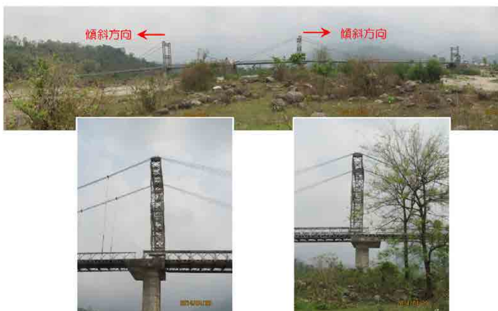
出所：調査団作成 〈図 7-15〉主塔の傾斜の状況
