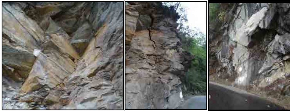
出所：調査団撮影 <図 8-14> 現地斜面の状況
