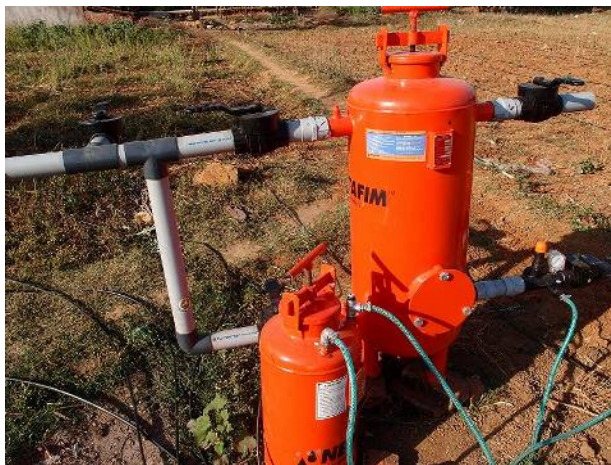
I-HIMDI で導入する施設と同じタイプの 直送式点滴灌漑施設 (Hazaribagh 県)
