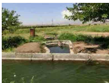
幹線水路沿いポンプ場 (WUA)
