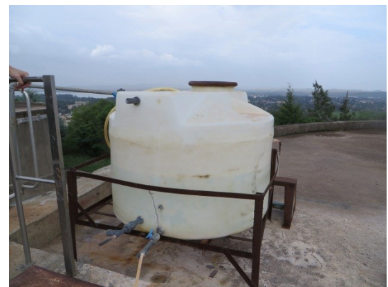
Part A で設置された塩素注入設備
