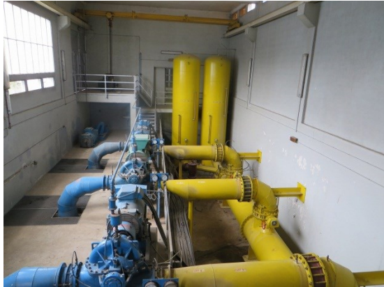
配水池の増圧ポンプ例
