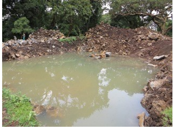
Part A のポンプ場建設現場 (Tikur Wuha) (地下水水位が高い)
