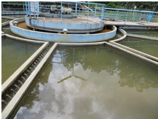
Gefersa 浄水場高速凝集沈澱池
