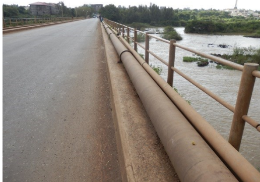
アバイ川を跨ぐ橋に渡された送水管（径 350 mm） Zone 1 と Zone 2 地区を繋ぐが、現在バルブが閉鎖
