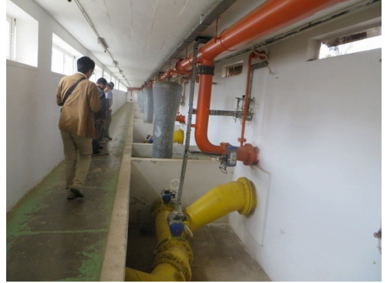
Legedadi 浄水場 (ろ過地出口)
