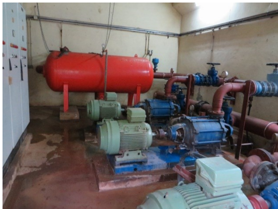
Abay 既存増圧ポンプ場
