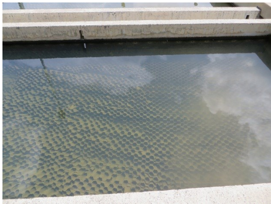
Legedadi 浄水場 (沈澱池の傾斜管)
