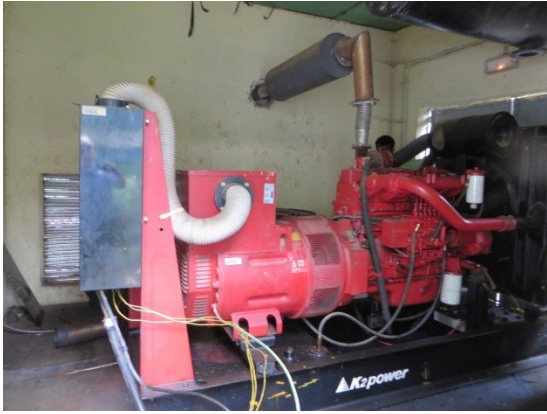
Part A で設置された Generator (Lome)
