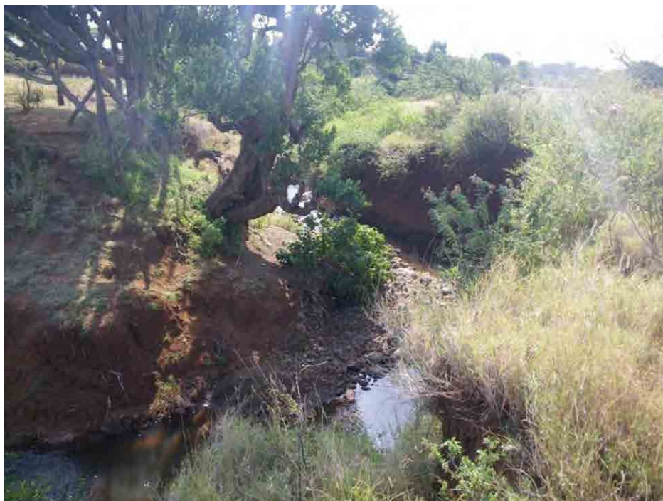
図 2.1.9 下流右岸側の河岸浸食箇所
