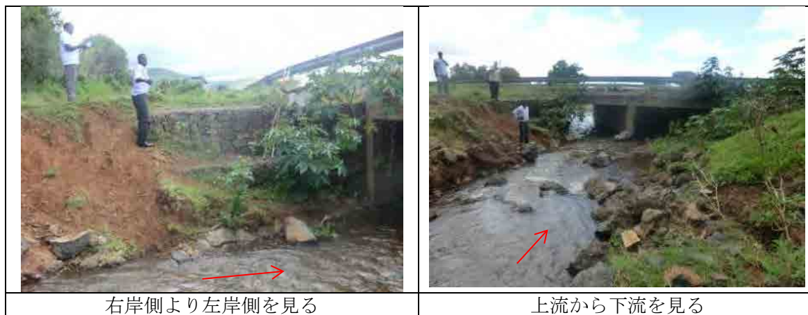
図 2.1.10 河岸浸食地点 No.2 の状況
