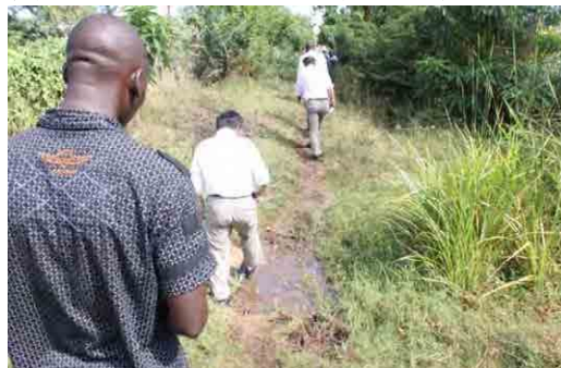
写真 3.1.4 Canal-C の堤防が人為的に破壊された地点
