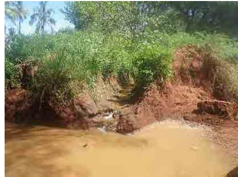
側面からのフラッシュフラッドによって 破壊された用水路
