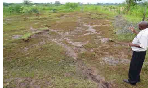
写真 3.1.2 Canal-C の堤防が決壊した箇所
