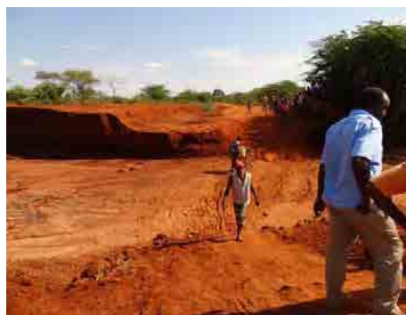
道路橋が流失した様子
