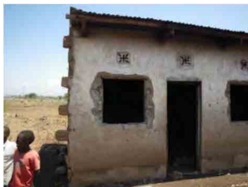
洪水により破壊された家屋
