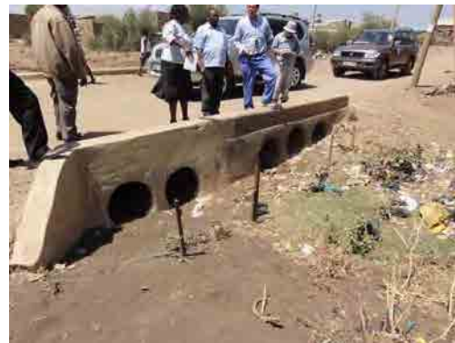
Isiolo 市街地の Merire 川沿いに設置されているカルバート
