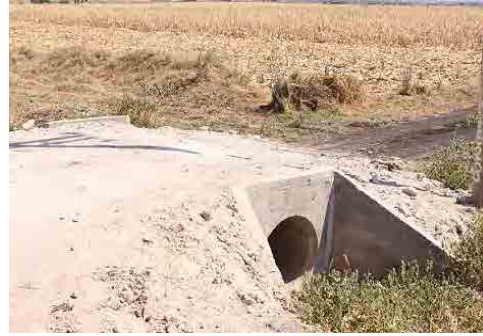
空港近くに設置されているカルバート 場所: Isiolo Town
