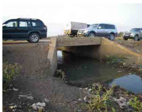
Merire 川の Isiolo 市街地最下流部にかかる ボックスカルバート構造の橋(下流を望む)
