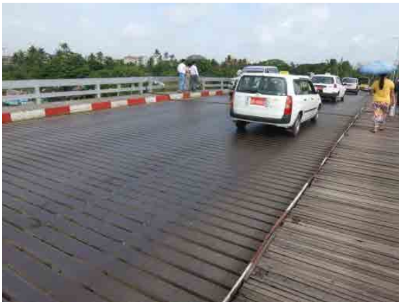
揺れ・振動が問題となっている開跳橋部。車道部は溝形鋼を床材として使用している。
