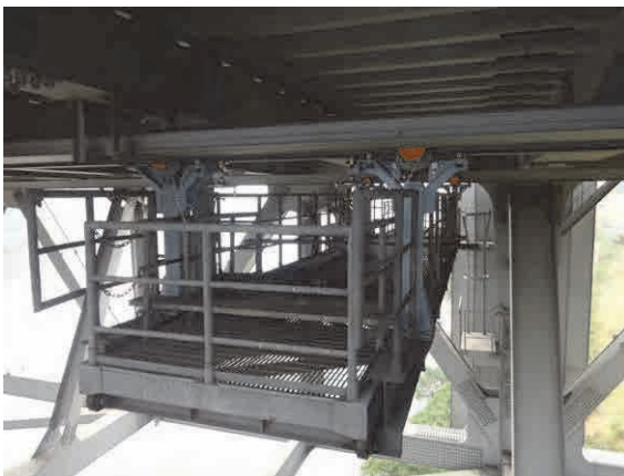
Chariot d'inspection existant après remplacement du système de motorisation, du dispositif anti-oscillation et des pièces de suspension
