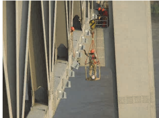
Mise en place des supports avec le support de travail suspendu de l'OEBK
