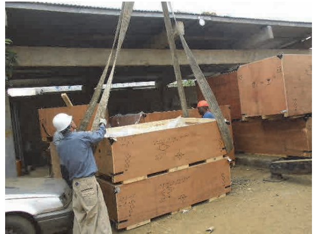
État actuel de la sortie des équipements requis
