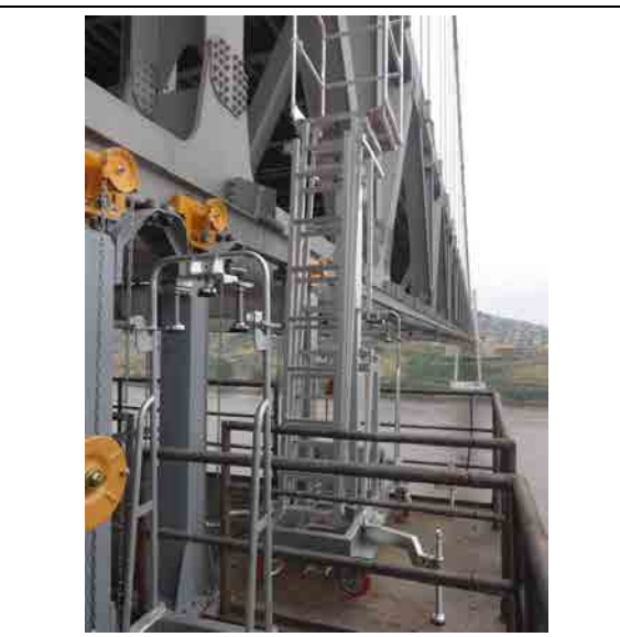
(9) Système de motorisation du chariot d'inspection de la surface inférieure existant (Côté A2)
