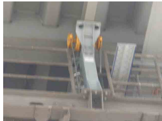
(7) Système de motorisation du chariot d'inspection de la surface supérieure existant (Côté A2)
