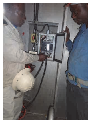
Vérification de l'alimentation électrique
