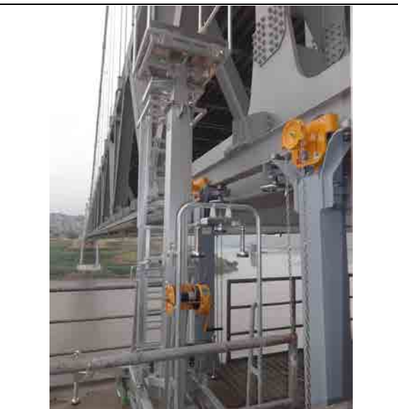
(8) Système de motorisation du chariot d'inspection de la surface inférieure existant (Côté A1)
