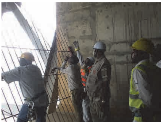
Inspection finale en présence du Directeur général de l'OEBK (Vérification du fonctionnement du chariot d'inspection de la surface supérieure existant du côté A1 à partir de l'intérieur du bloc d'ancrage)
