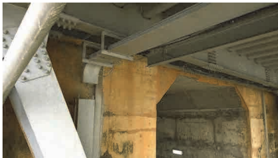
Traces de réparations visibles à la surface du béton, les conduites de câblage font également obstacle
