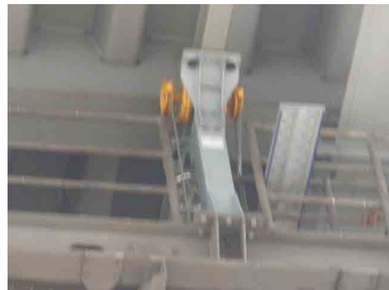
(7) 既設上面点検検査車駆動装置 (A2側)
