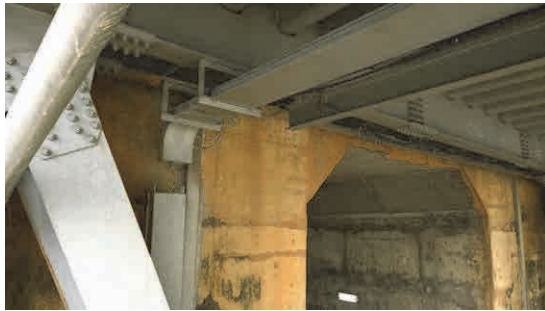
コンクリート面に補修跡が見られ、 配線ダクトも障害となる
