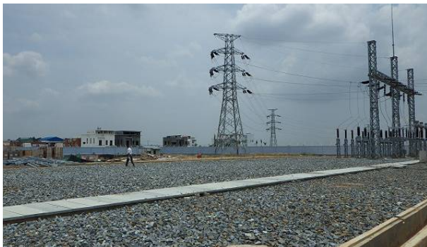
1) 既設変電所内(115kV 母線北側)
