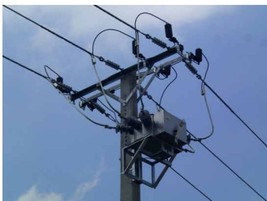
図 8.4-8 柱上用開閉装置
