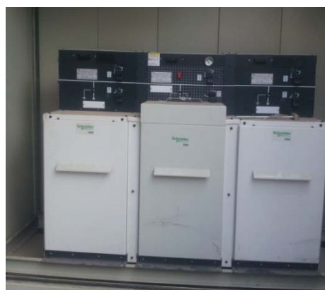
図 8.4-9 屋内用開閉装置
