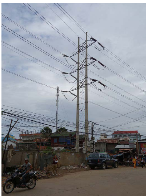
図 4.1-5 OHL_Route7 の分岐コンクリート柱
