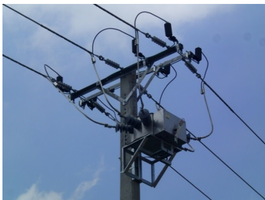
図 8.4-8 柱上用開閉装置
