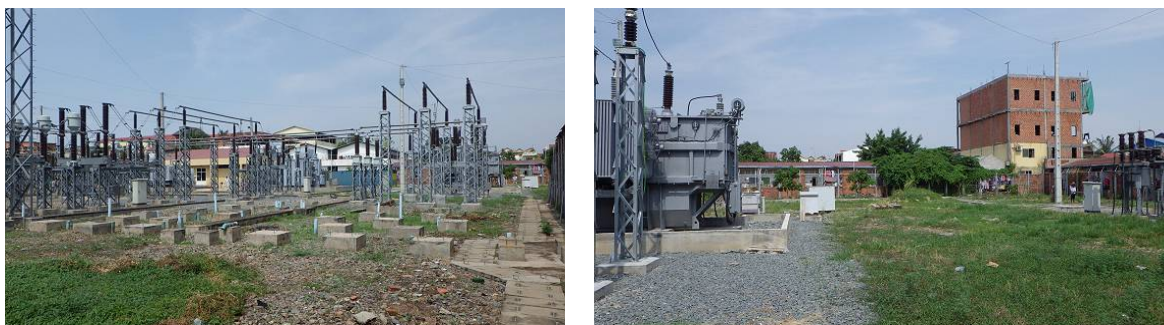
1) 開閉装置設置箇所
