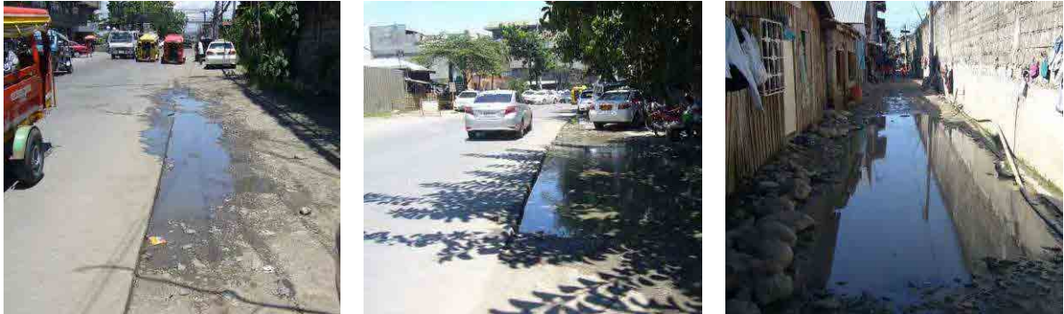
写真-3. 1. 2 市内の水溜り発生箇所の状況
