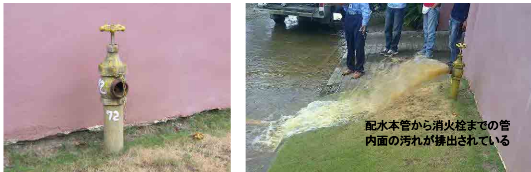
写真-3.2.3 地上式消火栓(右：消火栓からの排水)
