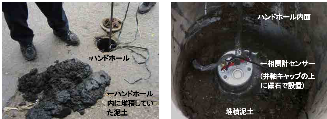
写真-3.2.2 維持管理されていない仕切弁室(ハンドホール)内 [3-7]
