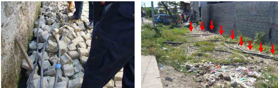
写真-3.2.5 違法接続箇所(左)と地上を走る露出配管 PVC 管(右) [3-11]
