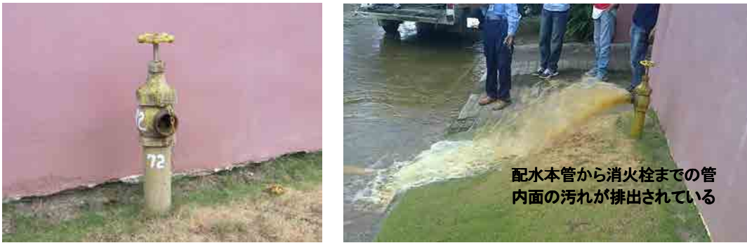
写真-3.2.3 地上式消火栓(右:消火栓からの排水) [3-7]
