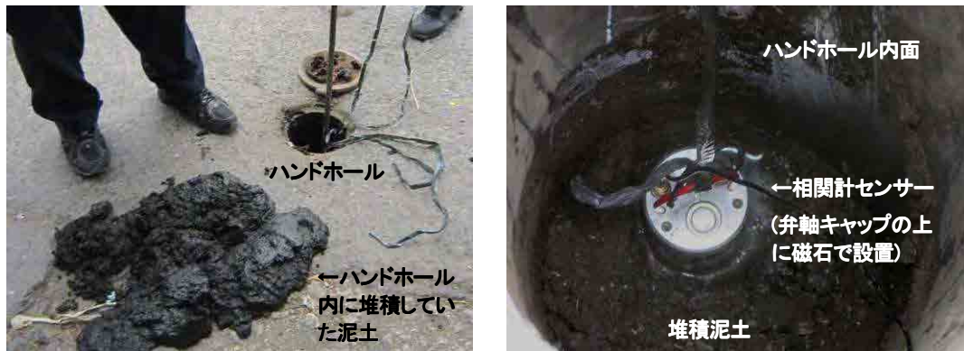
写真-3.2.2 維持管理されていない仕切弁室(ハンドホール)内
