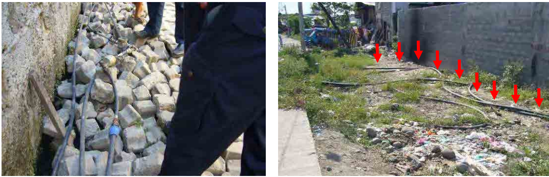
写真-3.2.5 違法接続箇所(左)と地上を走る露出配管 PVC 管(右)
