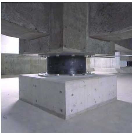
図5... アーチ交差点の基礎免震装置
