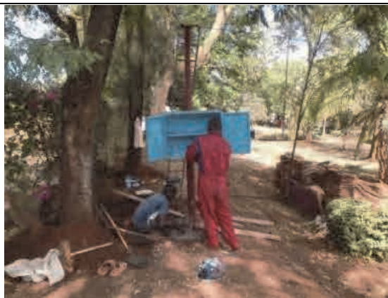
通信によるモニタリングシステム設置
