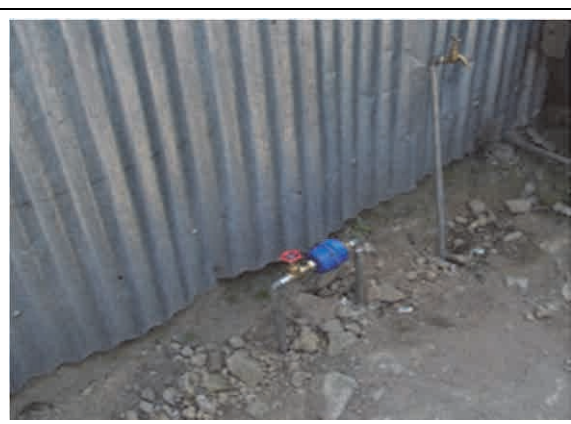
地表露出型に変更した後の顧客メータ
