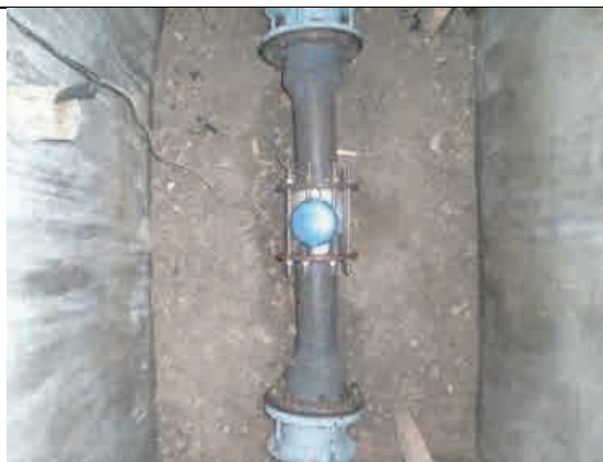
電磁流量計の設置
