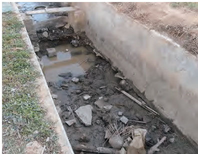
堆砂により流下能力が低下した灌漑水路 (Phaizau 小規模灌漑事業) (Champhai 県)
