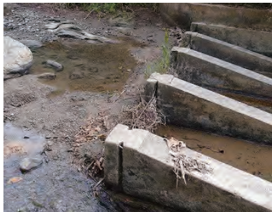
堆砂により機能が低下した頭首工 (Dialdawk 小規模灌漑事業) (Mamit 県)
