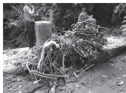
滞砂により機能が低下した頭首工 (Dialdawk 小規模灌漑事業) (Mamit 県)
