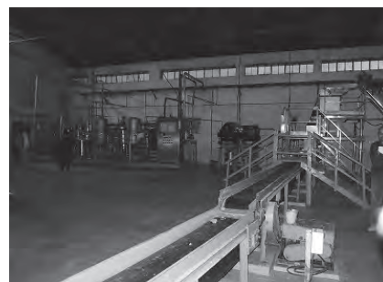
産業局が運営している MIFCO の ジュース工場内の設備 (Serchhip 県)
