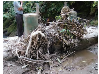
木枝が堆積し機能不全となっている灌漑施設 (Blakin Lui 小規模灌漑事業) (Kolasib 県)
