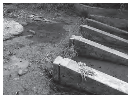
木枝が堆積し機能不全となっている灌漑施設 (Blakin Lui 小規模灌漑事業) (Kolasib 県)
