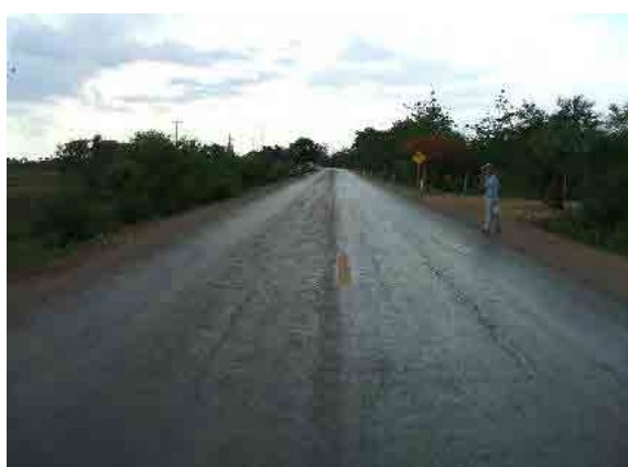
Longitudinal Crack (KP 224)
