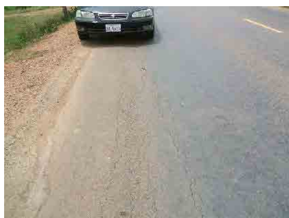
Mesh Crack (KP 236)
