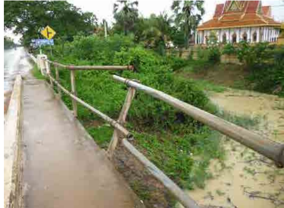
図 4-7 59 番橋梁の損傷したままの高欄
