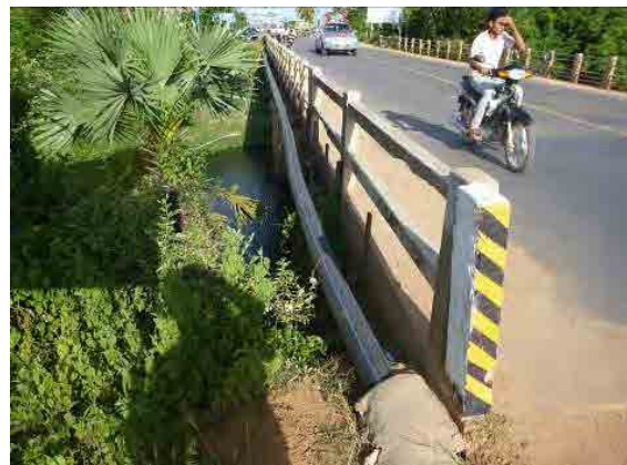
48 番橋梁 (KP 187 + 500) に添架された水道管
