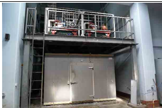
■フレーク製氷機+貯氷庫4ト、 製氷能力 2ト/日×2基、冷媒 R22。経年劣化 が進んでいるため本プロジェクトで更新し、 相手国の要望により冷媒をアンモニア化する 予定
