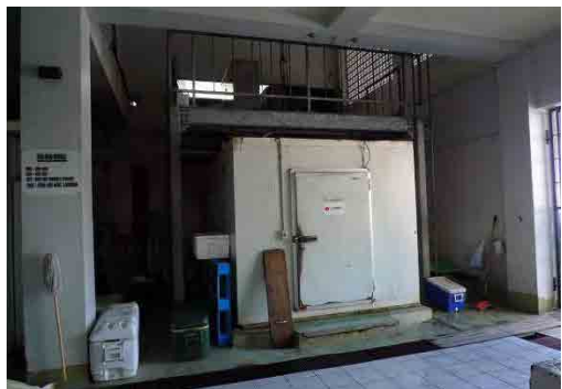
■既存プレート製氷機+貯氷庫6ト 製氷能力 2.5ton/日×2基、冷媒 R404 を使用。 経年劣化が進んでいるため本プロジェクトで更 新し、相手国の要望により冷媒をアンモニア化 する予定
