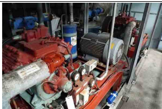
■フレーク製氷機の冷凍機 よく使われているが、経年劣化が進んでい るため本プロジェクトで更新し、相手国の要 望により冷媒をアンモニア化する予定
