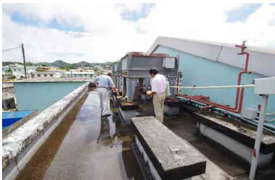
■ 空冷コンデンサー置場 冷蔵棟の屋上に置かれている。冷媒効率を上げるため、蒸発式コンデンサーに転換し、地上に配置する
