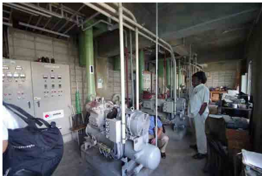
■ 機械室内観 1 急速凍結庫及び冷蔵庫用冷却設備。メンテナンス状態は非常に良い。右手はメンテナンス主任
