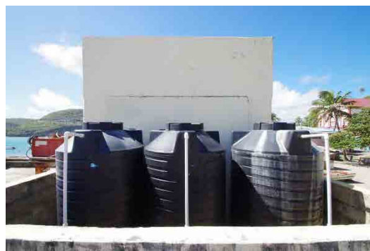
■ 本棟屋上 2 製氷機用受水槽
