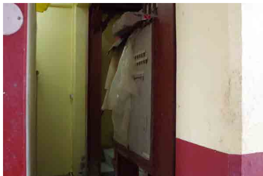
■ 貯氷庫用制御盤(本棟) 雨水漏れで危険な状態。新機械棟に移転し、更新予定
