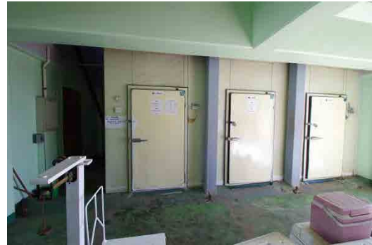
■右から冷凍庫 (-20°C)、貯氷庫及び冷蔵庫： 経年劣化のため、今回全て更新 冷媒は R404a に変更する
