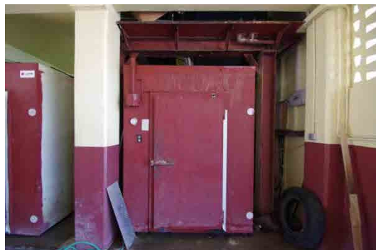
■ 貯氷庫(本棟) 2 トン/日の製氷機が稼働中であるが、経年劣化のため 上部に設置されている製氷機とともに更新予定
