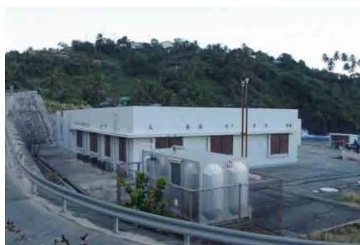
■手前の受水槽はポンプが故障し、使われていない。市水に直結して受水している。市水は川水を直接受水しているため、降雨時は濁水となる
