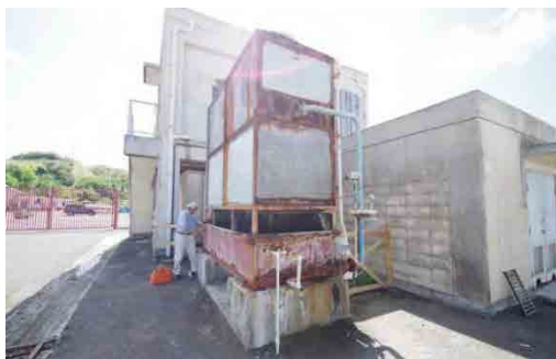
■蒸発式コンデンサー 機能しているものの塩害による錆びで、今後の持続性に問題があるため、更新予定
