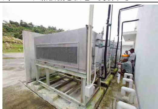
■空冷式コンデンサー及びレシーバー： 海水飛沫が電蝕を加速させ、全体が錆により劣化している。本プロジェクトで製氷機用のコンデンサーのみ交換する。水冷式にする
