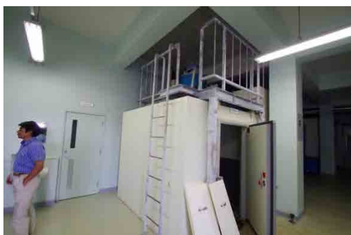
■製氷機・貯氷庫： 現地調査時、冷凍機に油漏れが発生したため、休止した
