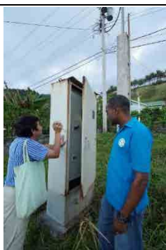
■受電盤：海水飛沫にさらされて盤のカバーが錆びて漏水しており、危険な状態にある。本プロジェクトで交換する
