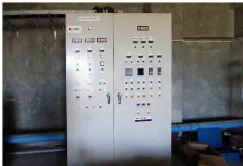
■機械室内観 2 冷凍機 3 基のコントロールパネル
