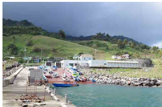
■水産施設の全景：棧橋先端部より。途中に給油機を保護するコンクリート製の小屋がある。海水飛沫が給油機側に巻き込み腐食させ、機能停止している
