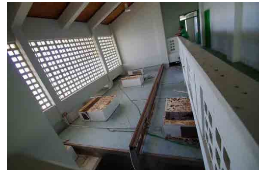
■改装した梱包室、冷蔵・冷凍庫の上部に本プロジェクトで更新予定の冷却器が設置されている
