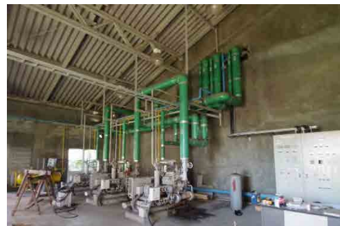
■機械室内観 凍結用冷凍機 2 基、冷凍庫前室用冷凍機 1 基の更新。冷媒はアンモニアに転換する。
