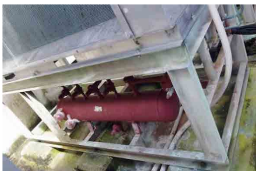
■レシーバーの錆：海水飛沫による電蝕で高压レシーバーに穴が開き、冷媒漏れが起きている。本プロジェクトで製氷機用のレシーバーのみ交換する
