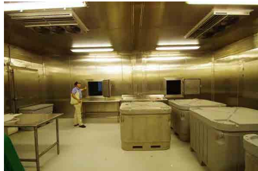
■梱包室： HACCP 対応。自国予算で増築・改装を行った。本プロジェクトで製氷機・貯氷庫及び冷蔵庫・冷却設備を更新し、冷媒を R404a に転換予定
