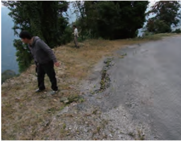
国道 4 号線 (Zhemgang-Gelephu) 路面上の地すべり頭部
