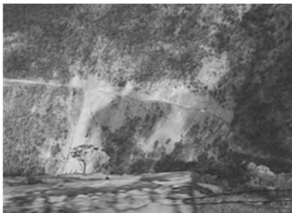
国道4号線 (Trongsa-Zhemgang) Reotala 崩壊地からシエムガンに向かう旧道。 道路沿いの斜面の崩壊が、谷側にも植生の 破壊と崩積土砂の堆積で影響を及ぼしている。
