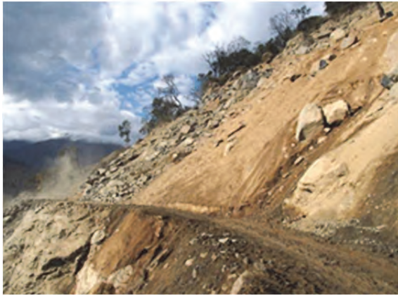
1車線がぎりぎり確保されている。
