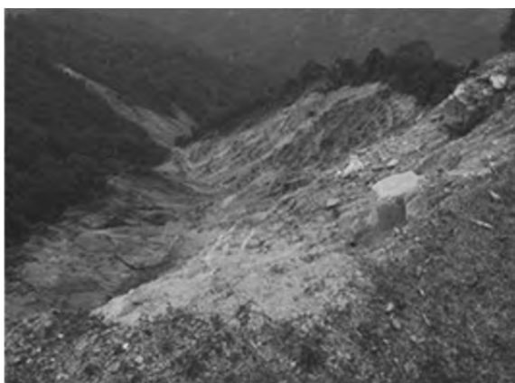
Zhemgang-Gelephu : 谷側のすべり 急傾斜すぎるため、擁壁等を立てられない。
