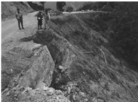
谷側の石積み擁壁工、基礎が流出 国道4号線 (Zhemgang-Gelephu)
