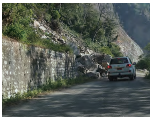
国道 4 号線 (Zhemgang-Gelephu) 擁壁
