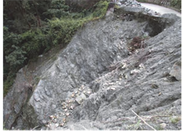
谷側斜面の状況、弱面に沿って楔状に抜け落ちたような状況だが、スレーキングと思しき斜面劣化も認められる。
