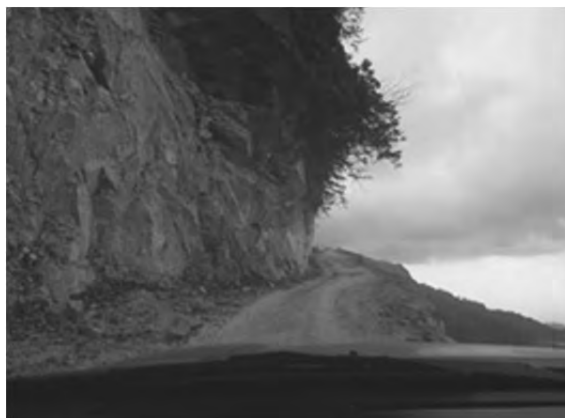
国道4号線 (Zhemgang-Gelephu) Box Cutting 崩壊地からゲレフに向かう途中の 斜面状況。不安定なオーバーハングと、 不安定な谷側斜面。
