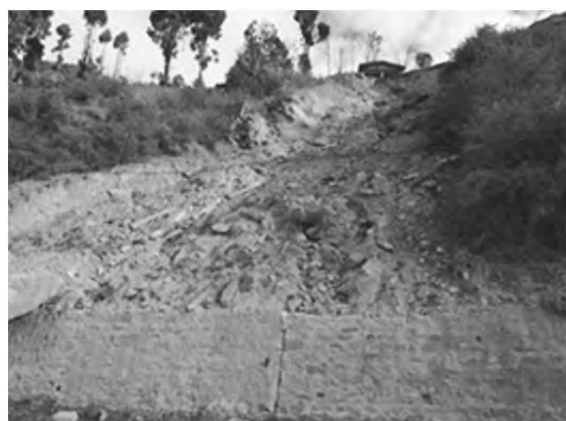
ガビオン、法枠工（残骸）、石積み擁壁工 国道1号線（Trongsa 地すべり）
