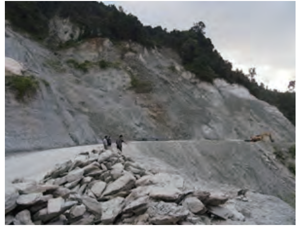
国道 4 号線 (Zhemgang-Gelephu) Box Cutting 崩壊現場
