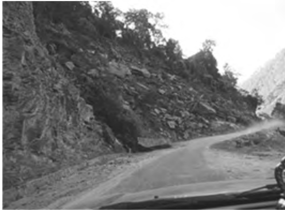
Zhemgang-Gelephu : 斜面崩壊
