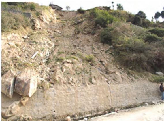
道路右側斜面の崩壊、法枠の残骸が散見され 斜面中ほどにガビオンが認められる。
