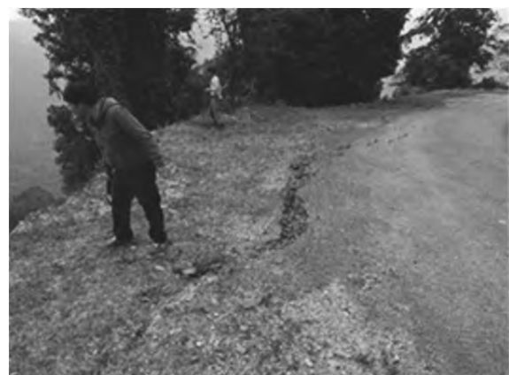
Zhemgang-Gelephu : 左写真の路肩部 滑落崖が後退しつつあり、 道路が失われる恐れがある。
