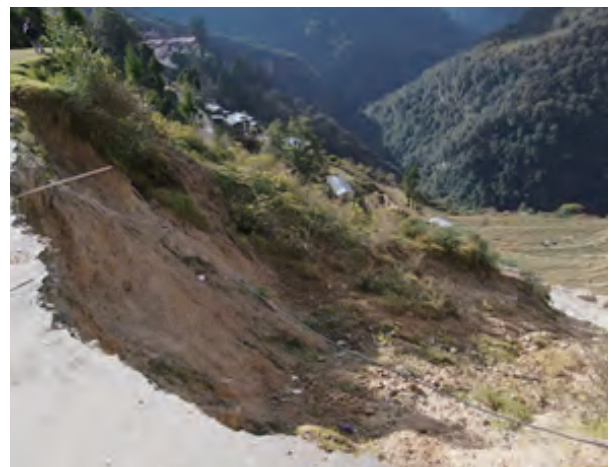
国道 4 号線 (Trongsa) 地すべり現場 (上側)
