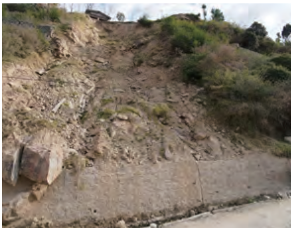
国道 4 号線 (Trongsa) 地すべり現場 (下側)
