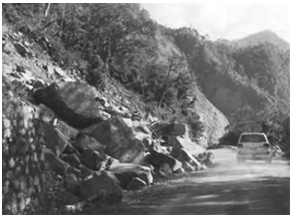
破壊された石積み擁壁工 国道4号線 (Zhemgang-Gelephu)
