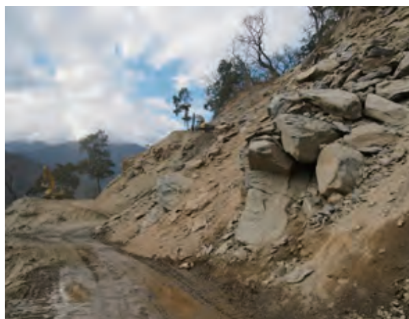
国道 4 号線 (Trongsa-Zhemgang) Reotala 崩壊現場
