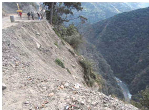
谷側の状況、路肩まで崩壊が迫る。
