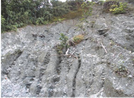
山側斜面の状況、ガリー浸食が顕著
