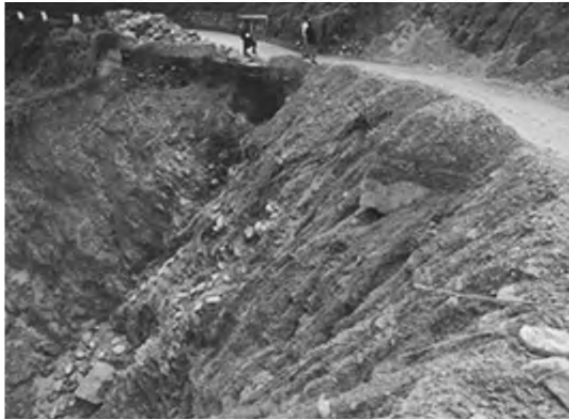
Zhemgang-Gelephu : 側のすべり Box Cutting 崩壊地の近傍、バクサ層群の千枚岩 による崩壊。路肩が失われている。
