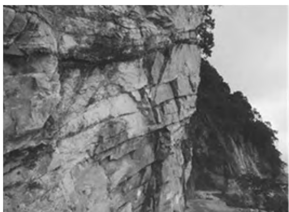
国道4号線 (Zhemgang-Gelephu) Box Cutting 崩壊地からゲレフに向かう途中の、 大規模な岩盤斜面。遠景の斜面では 流れ盤による抜け落ちが懸念される。
