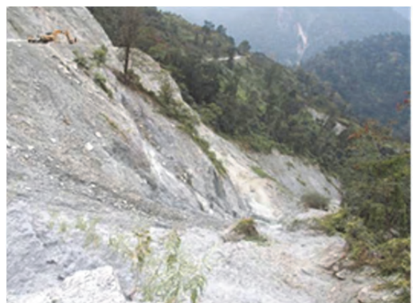
急傾斜を呈する谷側斜面
