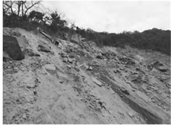
切土小段造成 国道4号線 (Reotala 崩壊)
