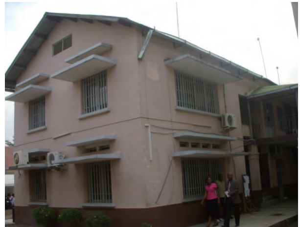
プロジェクトで改修された 保健省人材関連局 (DRH) の建物
