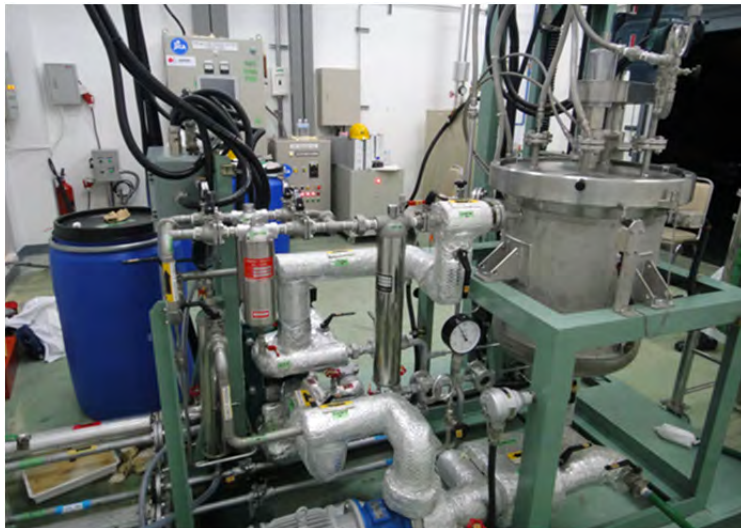
TISTR に設置した BDF 改質ユニット
