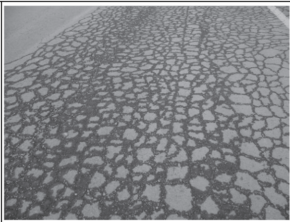
Concentración del tránsito pesado y estado del pavimento deteriorado por los efectos del agua.
