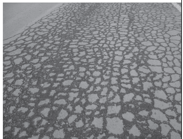
重交通の集中と水の影響によって悪化した舗装状況
