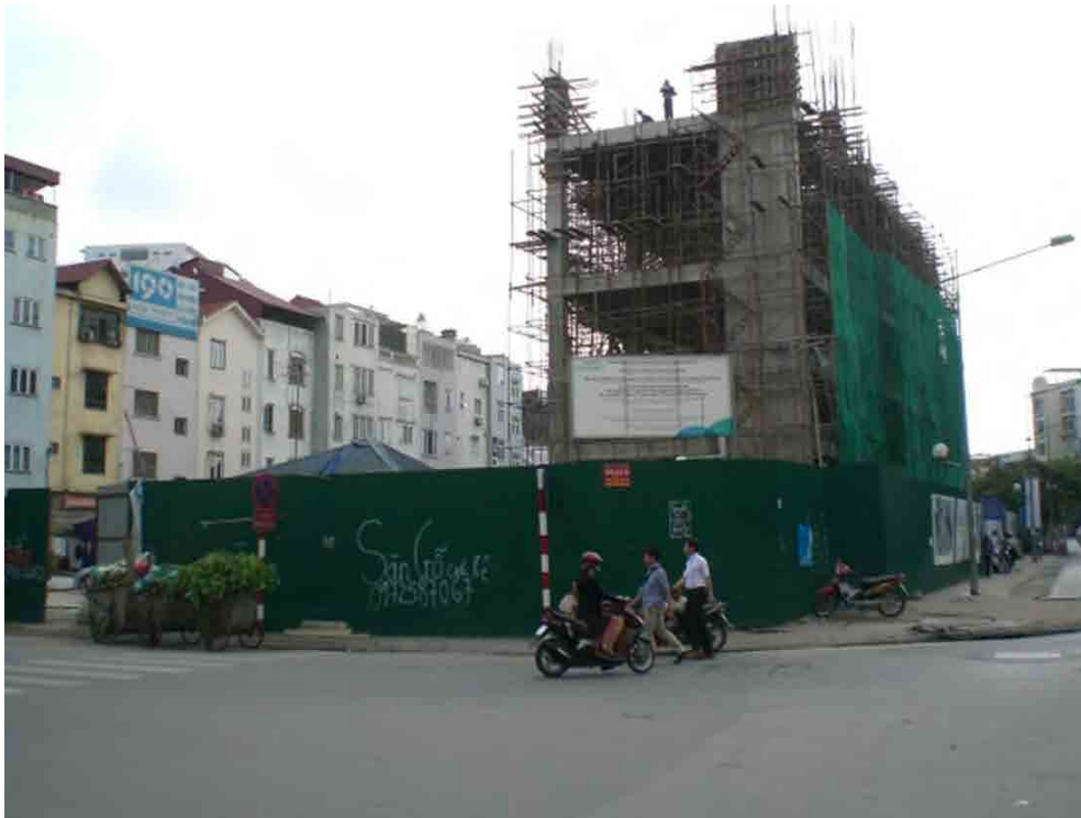
Hình 3.5 Địa điểm thi công Nhà chờ xe buýt nhanh tại Kim Mã
