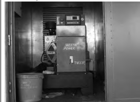
Generador, motores Mitsubishi
