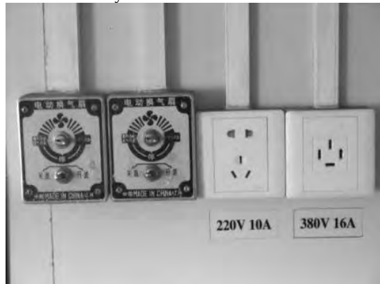
Tomacorrientes y encendedores de ventilador
