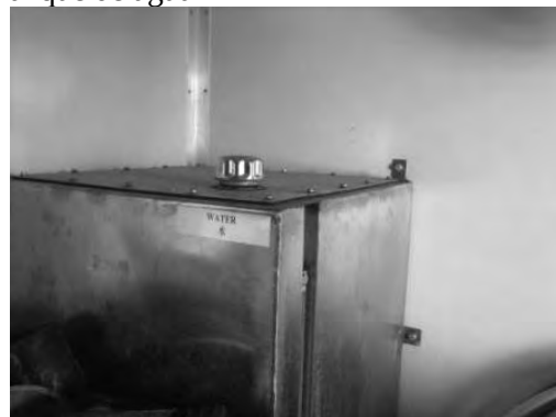
Tanque de agua
