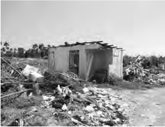
Caseta de control destruida y los residuos vertidos cerca de su entrada
