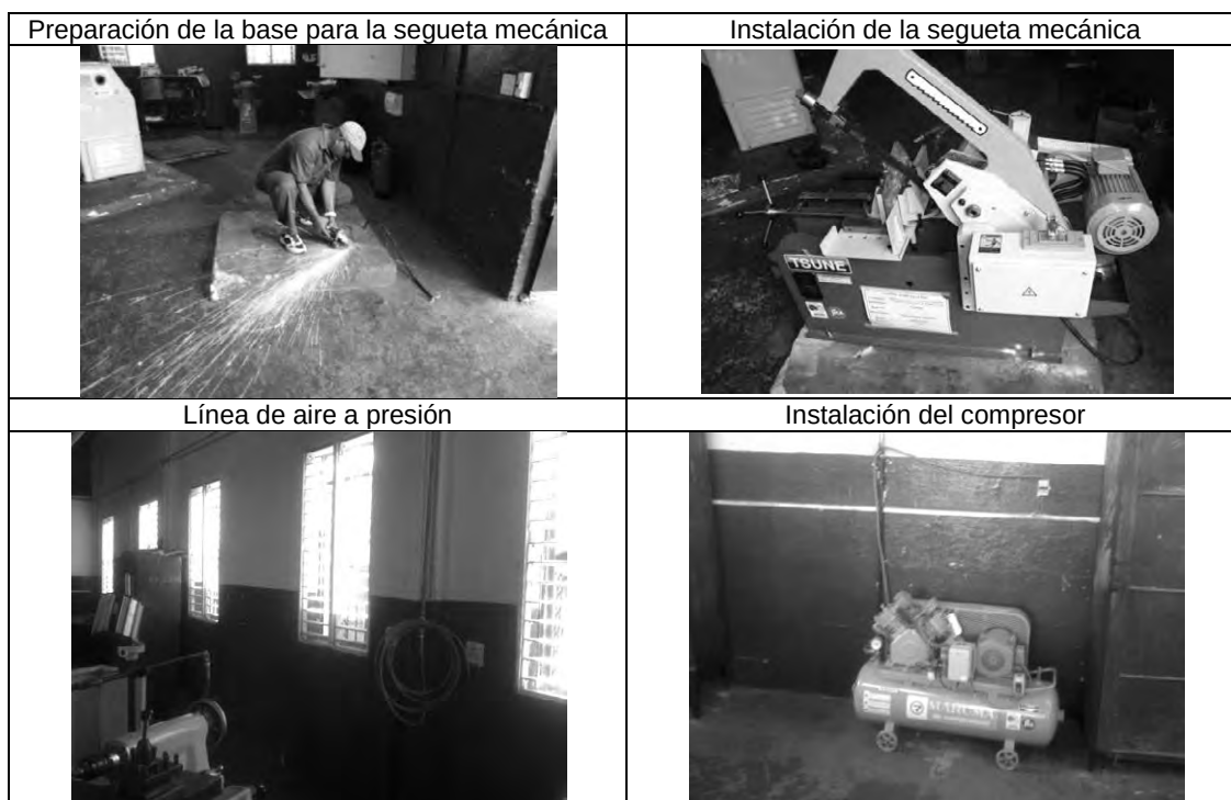
Foto 7-2: Cuarto de Maquinado (Següeta Mecánica y Línea de Aire a Presión)
