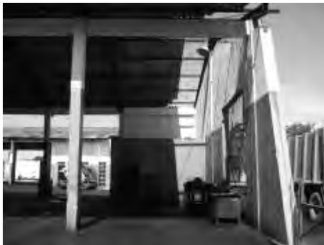
Área de hidráulica
