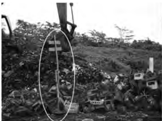
Foto 3-15:Contra de la altura con un poste de Madera
