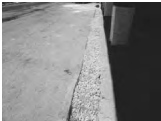
写真 1-24 : French Drain式排水溝
