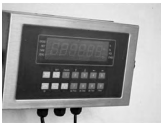
故障中のCalle 100のトラックスケール表示部
