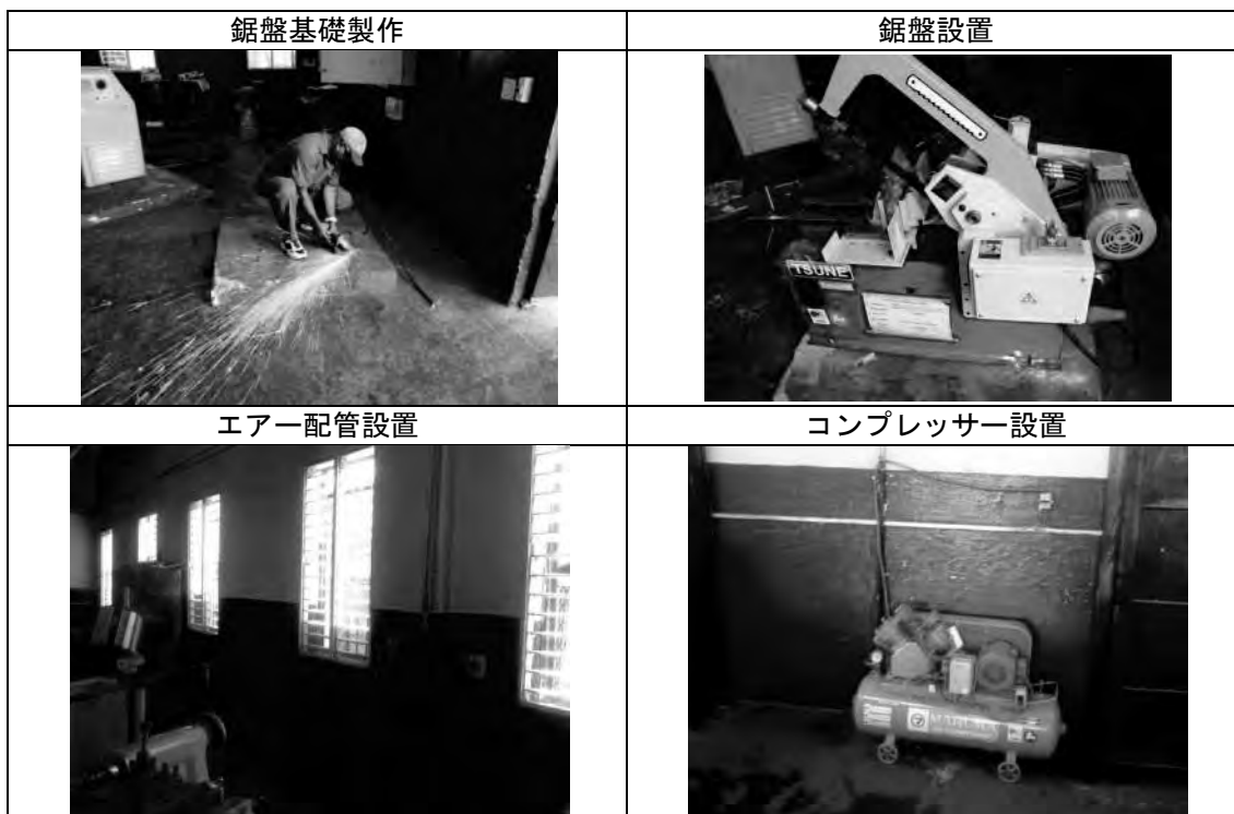
写真 7-2: 工作室 (新機材の鋸盤とエア配管)
