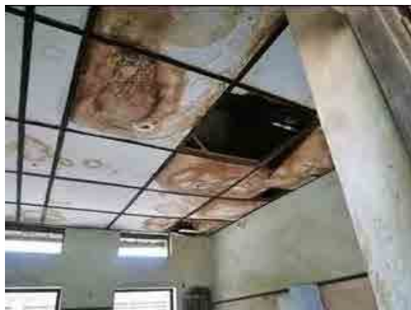
写真：教室の破損した天井
