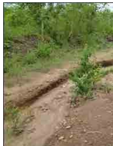
写真： 道路サイドの雨水浸食
