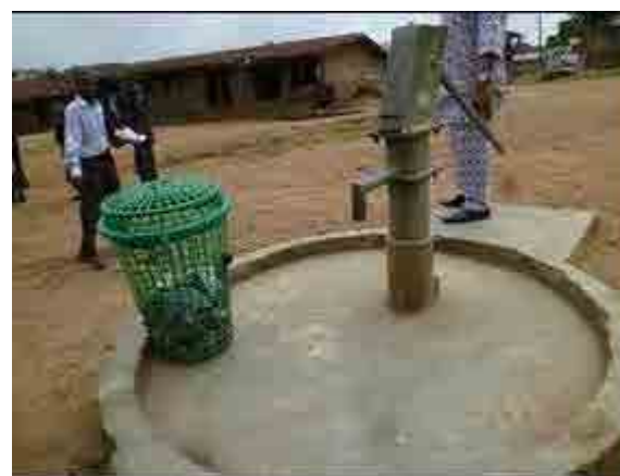
写真： 井戸ハンドポンプ
