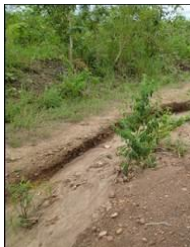
写真： 道路サイドの雨水浸食
