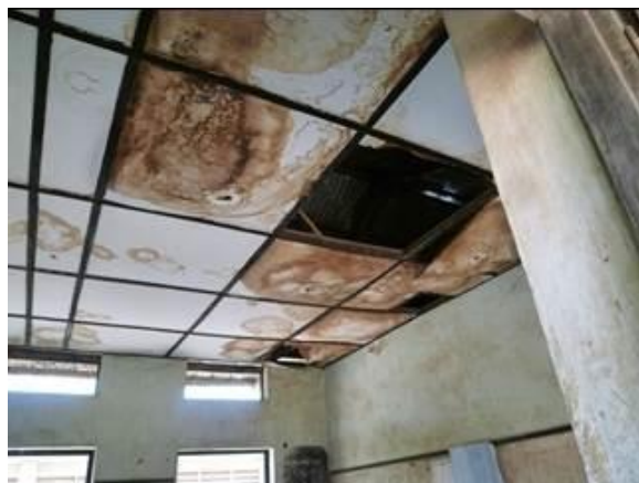
写真：教室の破損した天井
