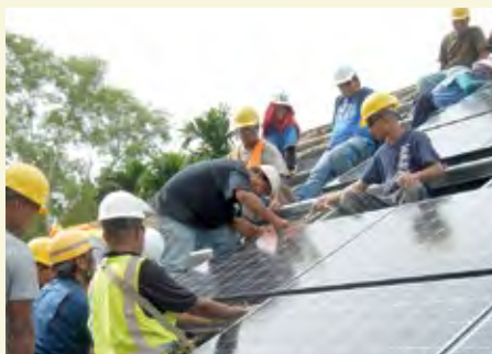
ミクロネシアにおける太陽光パネルの設置
