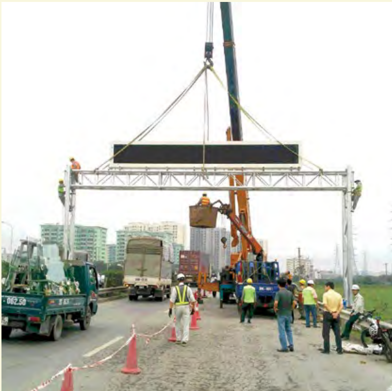
ベトナム・ハノイの高速道路に、無償資金協力で供与した交通管制システムを設置
