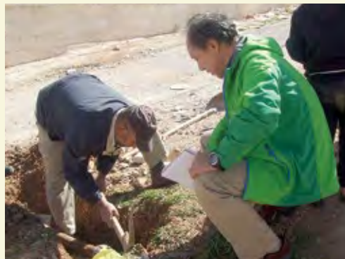
ホストコミュニティにおける上下水道サービスの現状調査で、配水管の状態を確認する調査団
