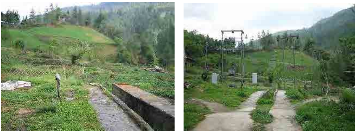
図 5-2 設備設置状況（左図:2012年5月 右図: 2014年5月）
