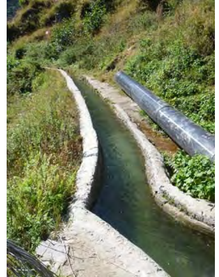
図 - 7.14 斜面崩落箇所 (1,080~1,095m) 迂回水路建設済
