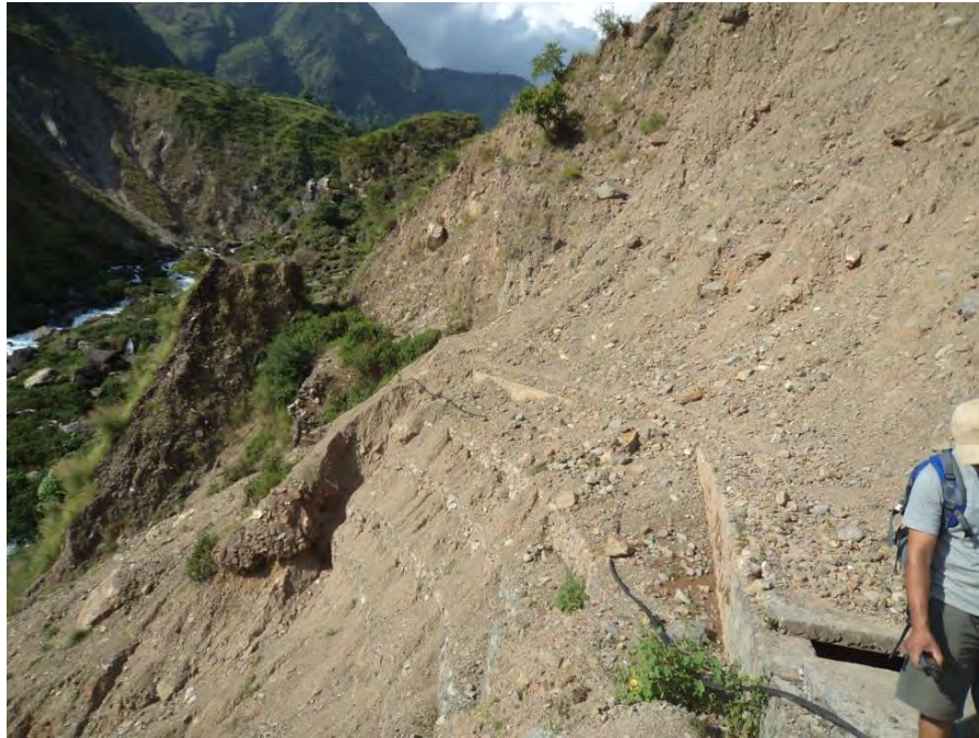
図 - 7.20 崩落箇所 (160~210m, 岩屑、砂質シルト) 蓋渠上に崩落土砂堆積
