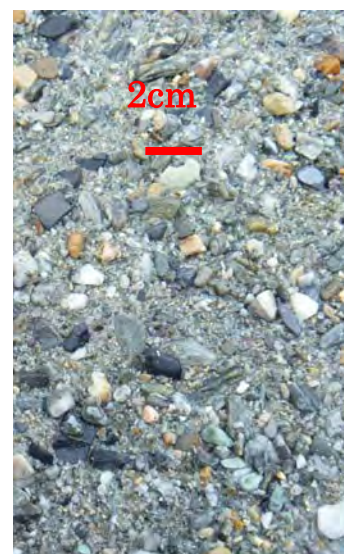
図-3.2 既設水路の堆積土砂 (取水口付近)
