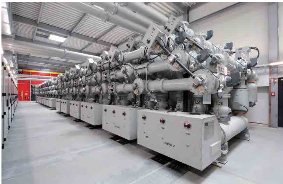
図 3-4-31 屋内に設置されたガス絶縁遮断機の例
