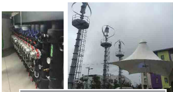
地中熱ヒートポンプシステムの配管・風車
