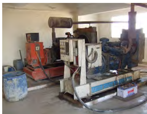
写真 16 食品加工工場に設置されている自家発 電機 照明に主に利用されている
