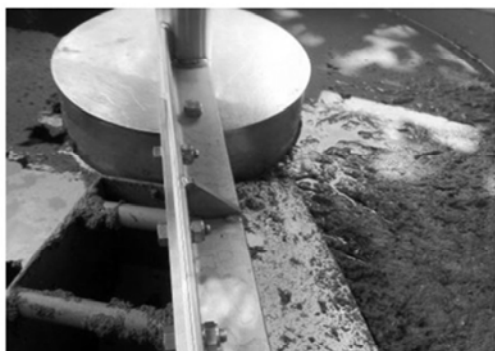
アオコ掻き寄せ装置 浮上したアオコ凝集物を掻寄せ
