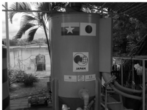
加圧浮上分離タンク
