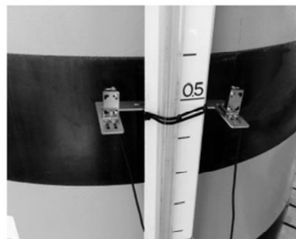
低水位検知装置 水位 50cm でアラーム発報
