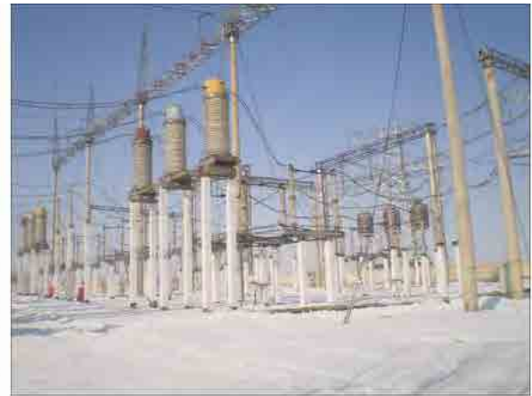
(d) The existing 220kV Switchgear Yard
