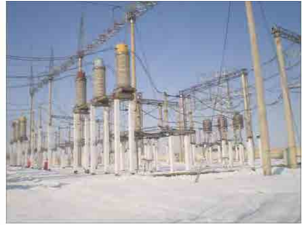
(d) The existing 220kV Switchgear Yard
