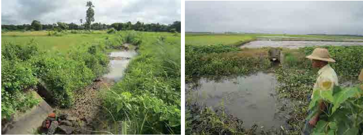
左: North Nawin 灌漑システムの支線水路に設置された直径 15 インチコンクリート製の取水口。農民が管理する末端水路へと通じている。右: Wegyi 灌漑システムの支線水路に設置されている直径 18 インチの取水口。水路周辺の水田に水を提供している。
