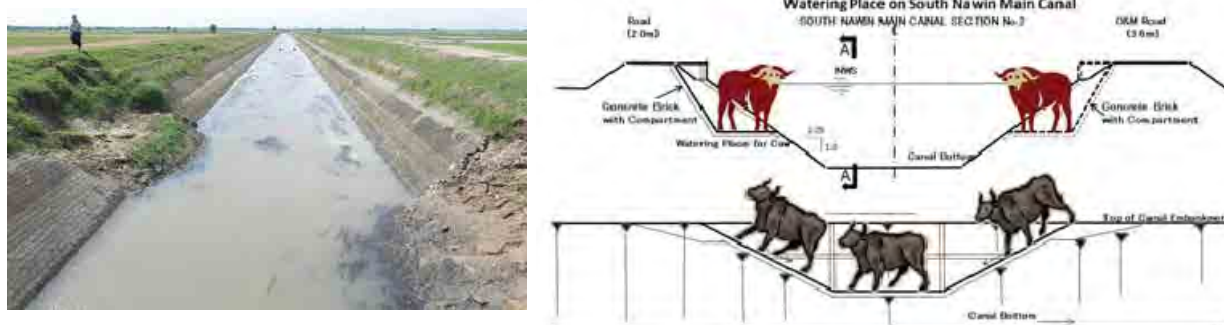
図 3.3.1 牛の横断により破損した水路法面（左）および水飲み場の概略図（右）
