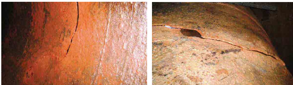
鋼製パイプの破損部分（内部より撮影：左、外部からの撮影：右）
