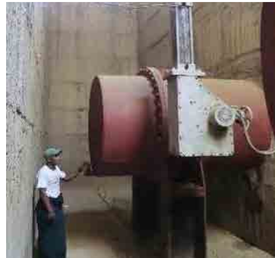
建設が中断している South Nawin 発電所の入口弁
